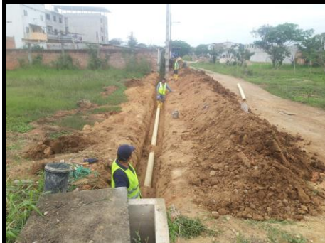
LOT. JARDINES DE CONCHALES: C. GILBERTO CONCHA Y K. Ampliación de 60m de red terciaria
