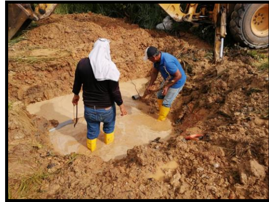
PARROQUIA SAN ANTONIO Fuga de AA. PP. en red principal de 110mm
