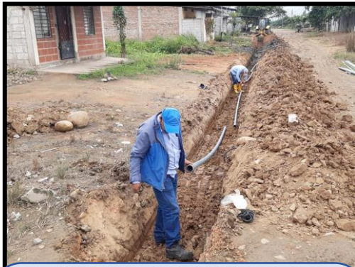
P. NUEVO STA. ROSA., CDLA. LAS ORQUÍDEAS: C. LOS LAGOS, LUIS PALADINES Y 8 DE DICIEMBRE Ampliación de 120m de red terciaria de AA.PP. de 63mm y cierre de circuito con redes secundarias de 110mm
