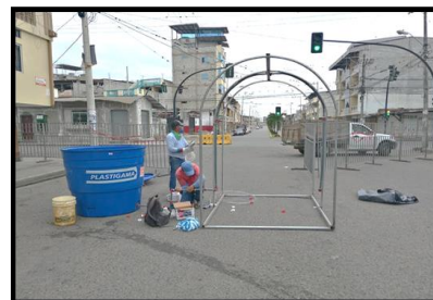
Instalación de módulo de desinfección de personas en las Calle Eloy Alfaro y Víctor Ollague para ingreso al Mercado Central y sus alrededores
