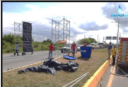
Instalación del sistema de aspersión para fumigar los vehículos que ingresan al Cantón Santa Rosa
