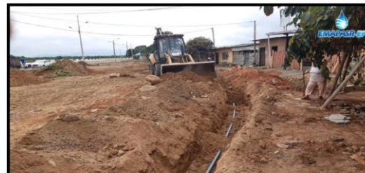
BARRIO MI ROSITA: C: MALECÓN Y AV. QUITO Ampliación de 100 m de red, tubería de 50mm
