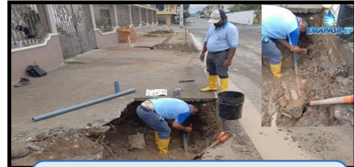
BARRIO CRISTO DEL CONSUELO: reparación de fuga de agua potable en c./ Machala y Av. Sixto Durán
