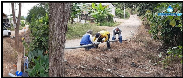
CDLA. SOL DE ORIENTE - PARROQUIA LA AVANZADA Ampliación de 200ml de tubería de 90mm y 63mm
