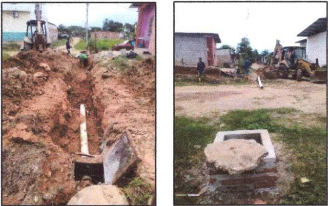
CALLE J. DURÁN, SECTOR EL NAZARENO – PARROQUIA NUEVO SANTA ROSA (CAMBIO DE TUBERÍA APLASTADA)
