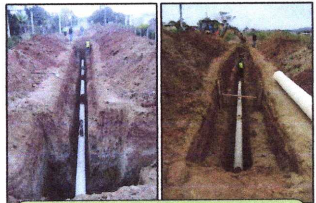
AMPLIACIÓN DE 130 m RED PRINCIPAL DE ALCANTARILLADO CON TUBERÍA DE 315 mm EN CDLA. VITE CORONEL
